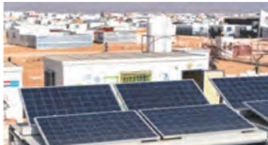
约旦扎塔里难民营的太阳能电池板
